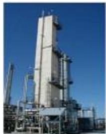
Small liquefaction Bio LNG
