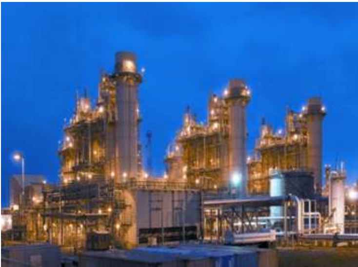
ExxonMobil Beaumont CHP Texas, USA (~500 MW)
